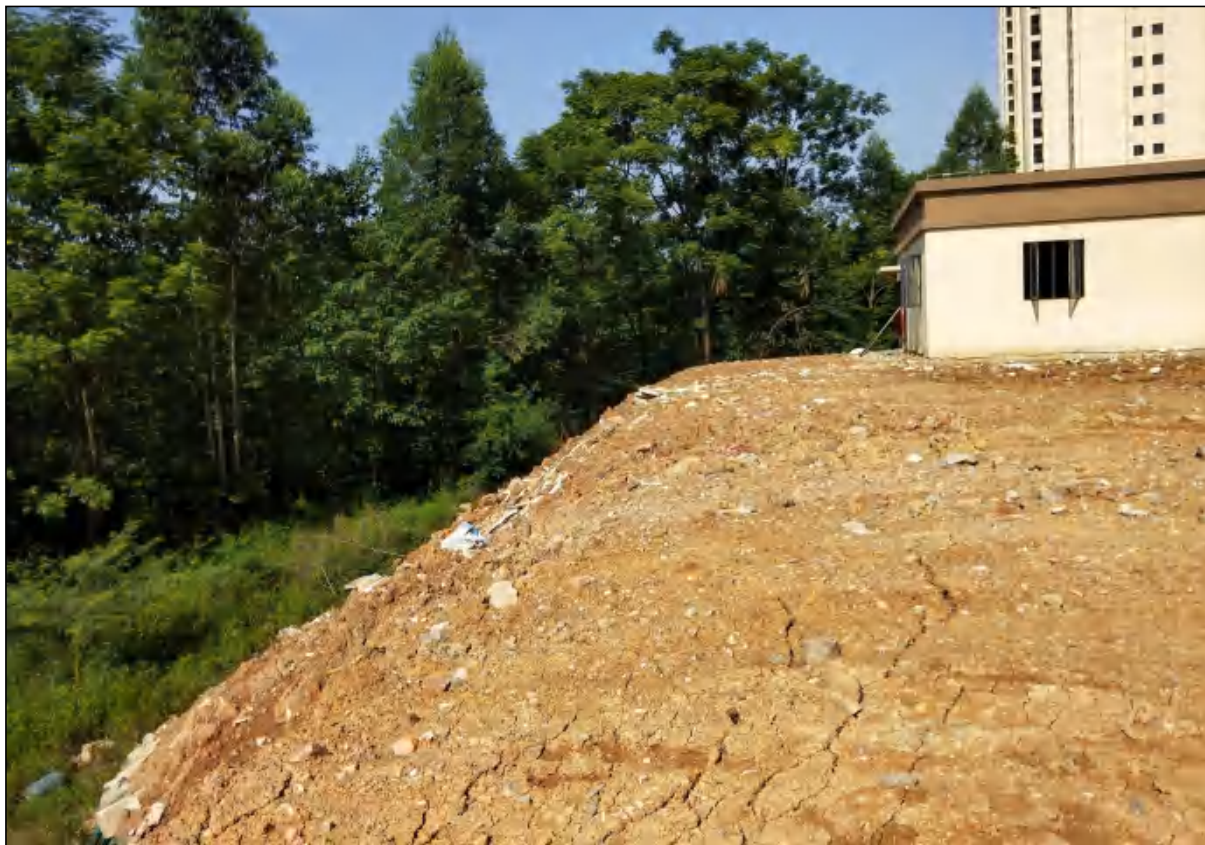
东地块东南面回填边坡现状，裸露面积较大，建议对坡面采取临时覆盖措施
