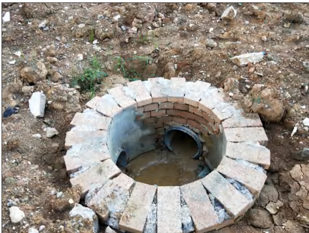
东地块雨水井现状，建议及时清淤
